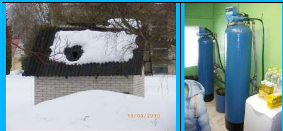
Joonis 8. Leevi Hooldekodu puurkaevpumpla ja veetöötlusseadmed. Fotod: OÜ Alkranel 19.03.2010.
