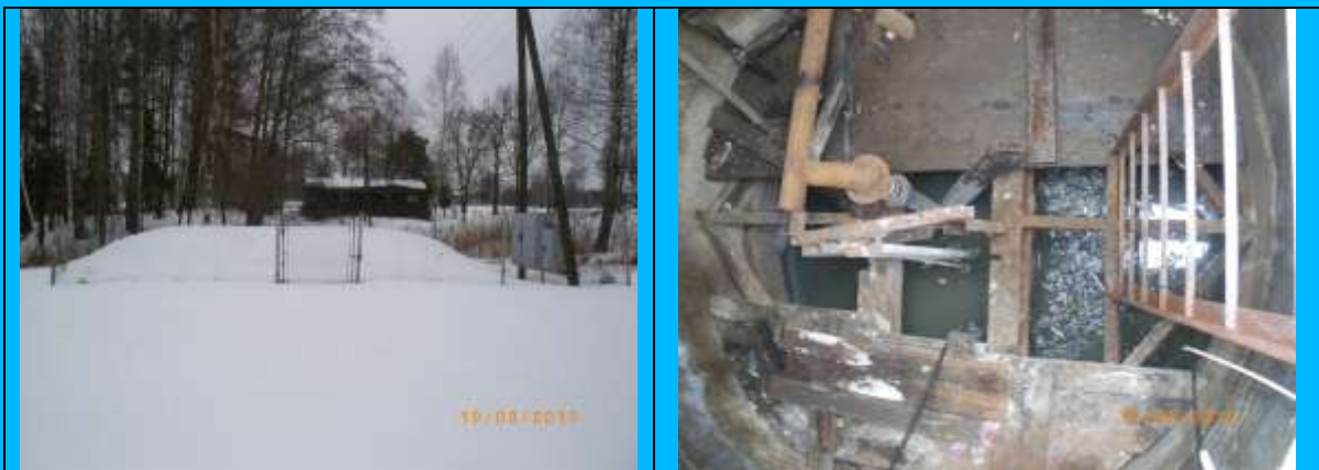
Joonis 6. Veriora aleviku reoveepumpla. Fotod: OÜ Alkranel 19.03.2010.
